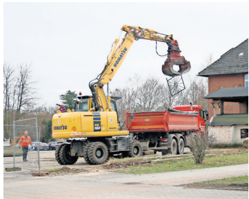
Bauarbeiten am alten Gutshof: Hier soll ein Wochenmarkt Einzug halten. FOTO: LISA NEUGEBAUER
