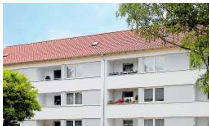
90 Wohnungen saniert die Buwog in Stöckheim: Dächer und Balkone werden erneuert, die Gebäude gedämmt. oh
